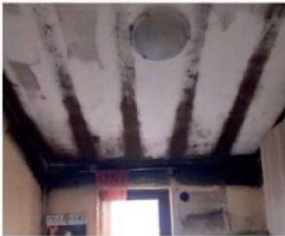
Le condizioni del soffitto della casa popolare; nel riquadro Vito Mercurio
